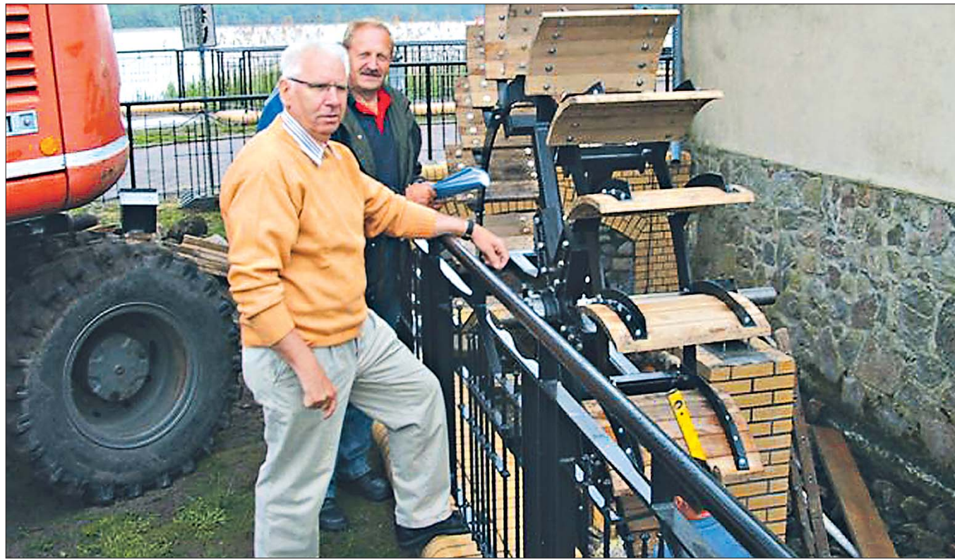
Dieter Eipel, der langjährige Bürgermeister von Lindow (vorn) mit Bauleiter Hans Schaar vor dem neuen Wasserrad.
