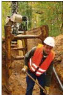
Erdarbeiten auf engstem Raum erfordern viel Geschick von den Fachleuten wie Frank Schultz von der Firma Eurovia.
