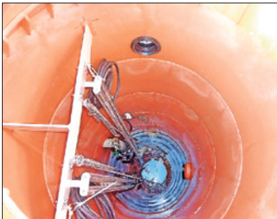
Für Pumpwerke gelten veränderte Baustandards.
