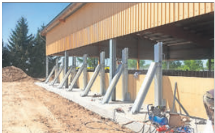
Um noch mehr Klärschlamm zwischengelagern zu können, wurden die Wände der Lagerhalle erhöht. Foto: TAV
