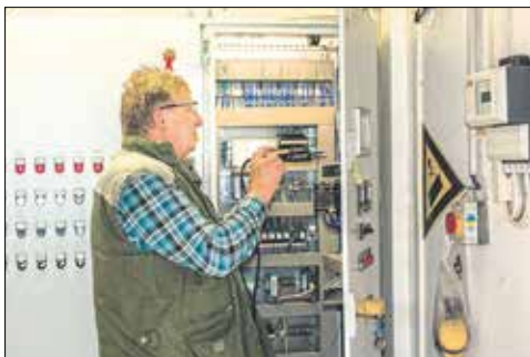
Der gelernte Elektriker Ronald Stresemann bei einem routinemäßigen Check der Anlage.
