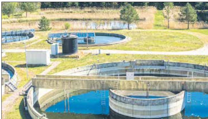
Die Kläranlage in Schönemark bei Gransee, hier wird das Abwasser mithilfe eines dreistufigen Reinigungsverfahrens aufbereitet.
