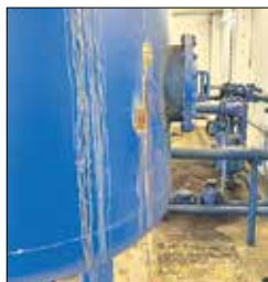
Durchrostung an der Filteranlage und schadhafte Fundamentplatte.
