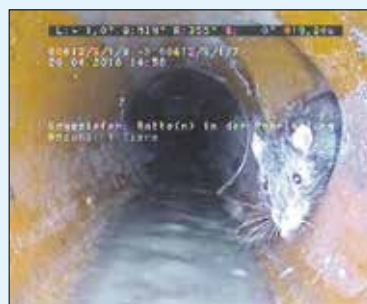
Erwischt! Dank TV-Inspektion entgeht den Kanalreinigern nichts.
