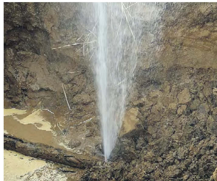
So weit muss es nicht kommen: ein kapitaler Rohrbruch im Garten. Foto: TAV
