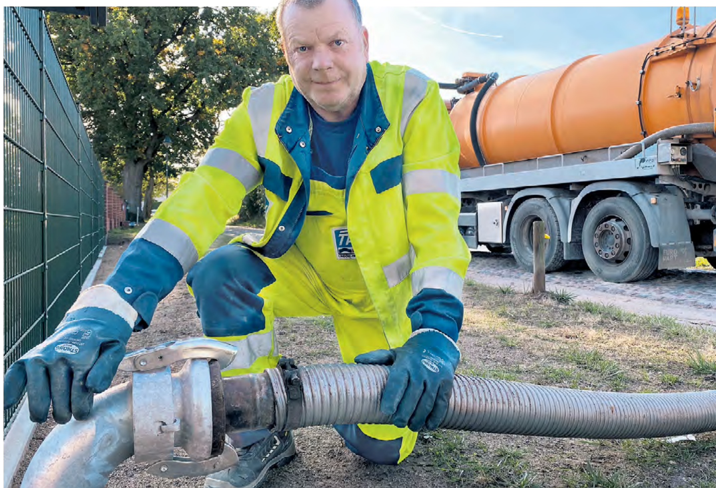
Axel Kühns ist jeden Tag im Verbandsgebiet unterwegs, um abflusslose Sammelgruben und Kleinkläranlagen zu leeren. An einem Saugstutzen wie diesem gelingt das besonders einfach.
